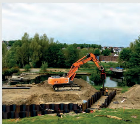
Wasserkraftanlage Schwitten | Fröndenberg
