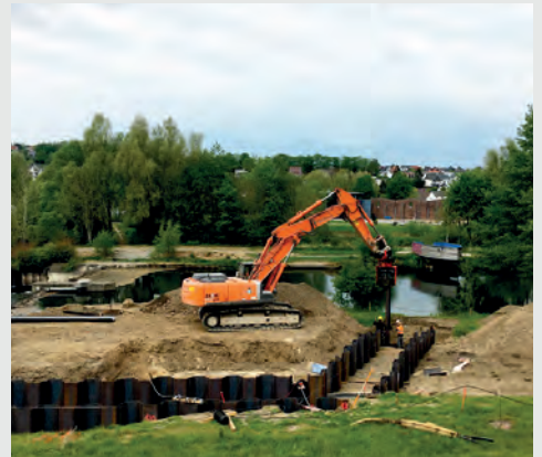
Wasserkraftanlage Schwitten | Fröndenberg
