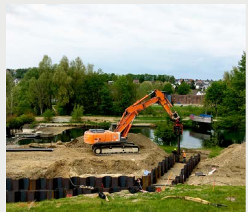
Wasserkraftanlage Schwitten | Fröndenberg
